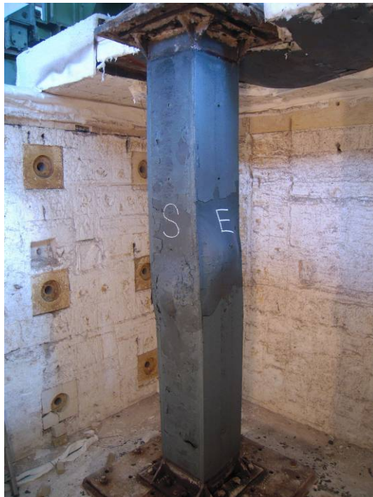
照片4：試驗後試體破壞情況(II)
