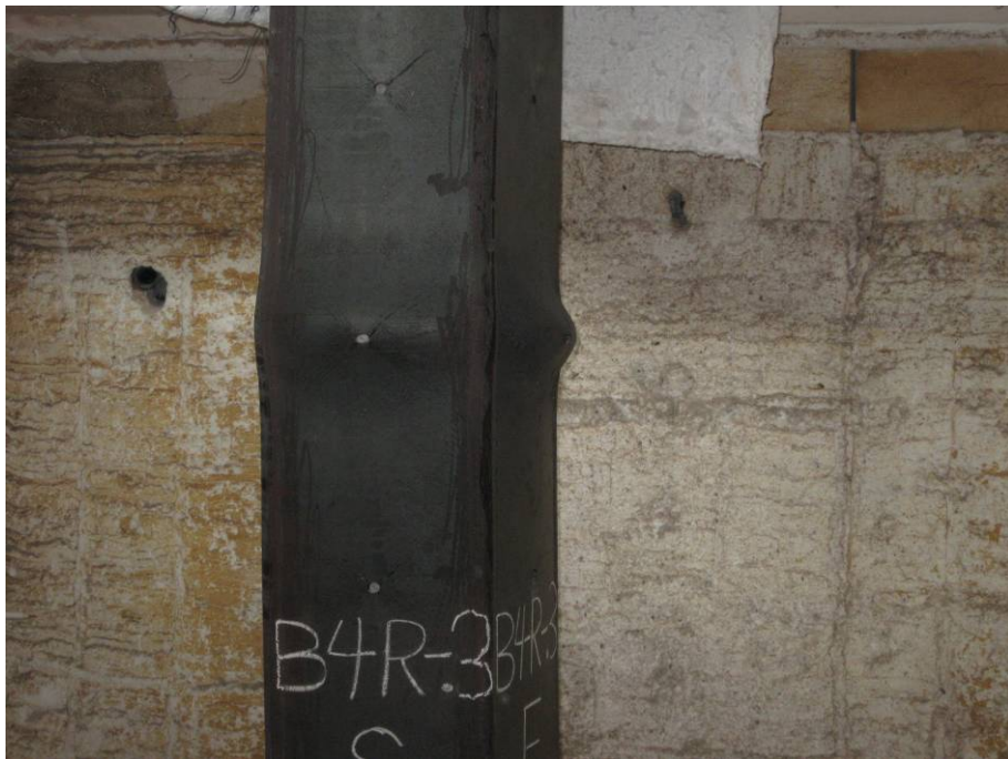
照片2：實驗後試體破壞情形(II)
