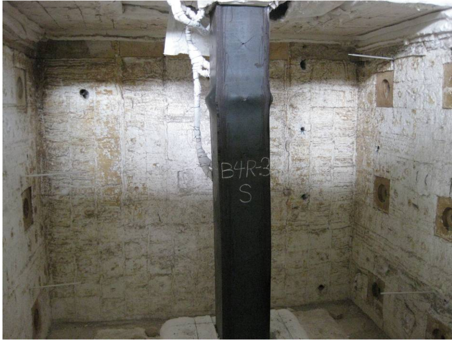
照片1：實驗後試體破壞情形(I)
