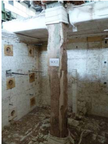
圖1 火害後鋼筋混凝土柱試體
